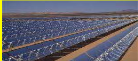
Netzintegration von Photovoltaikanlagen
